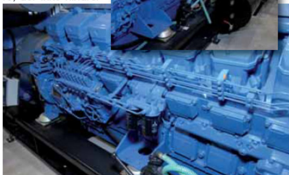
Mitsubisi har leveret dieselgeneratorerne til regulerkraftværket i Tønder.
